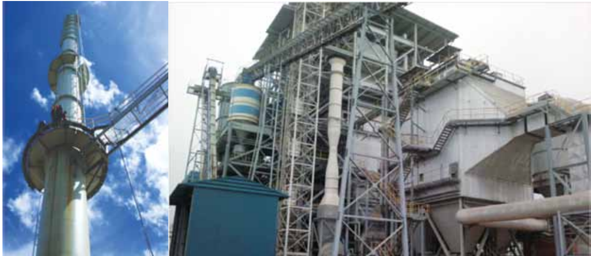
ปล่องระบายอากาศออกจากโรงงาน และเครื่องดักฝุ่นแบบไฟฟ้าสถิตย์ (Electrostatic Precipitator)
